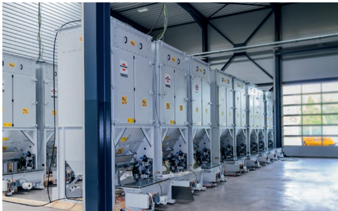
In einer extra dafür angemieteten Halle nahmen Volvo CE und Keller die Absauganlage vor Auslieferung testweise in Betrieb
