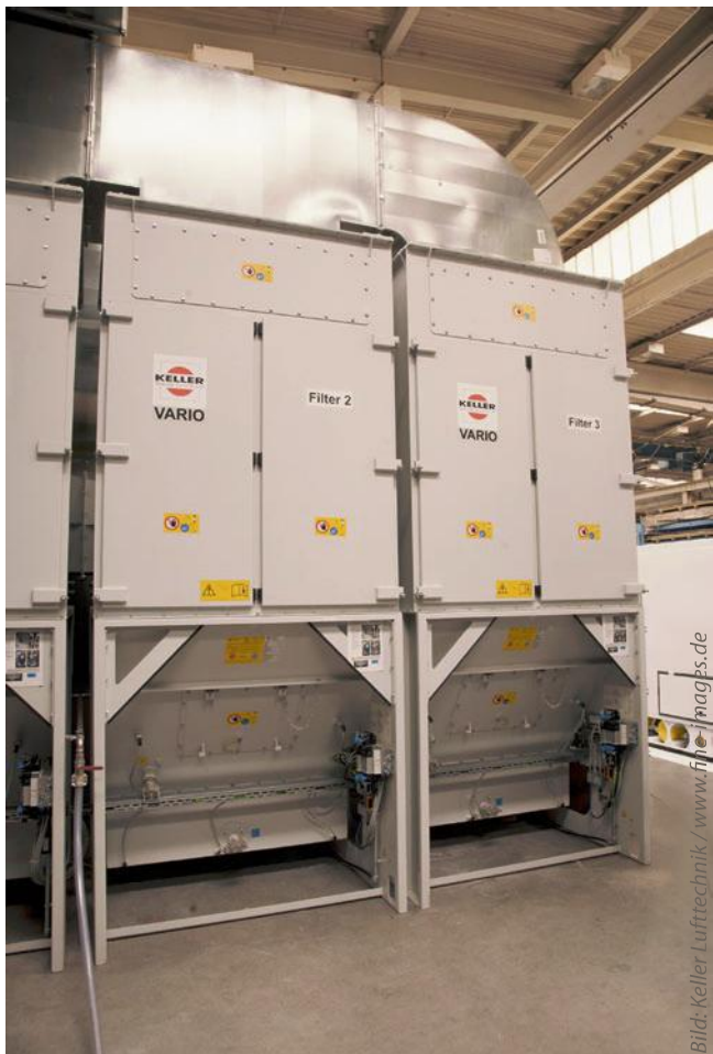
In drei Modulen mit textilen Filterelementen werden die Lackpartikel trocken abgeschieden
